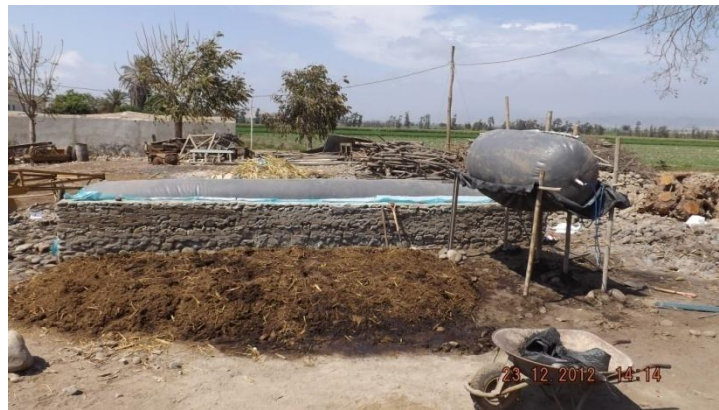
Foto 10. Biodigestor y gasómetro instalados en el IRD-Costa
